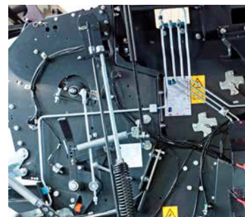
Tubi rigidi in acciaio per il circuito idraulico.
